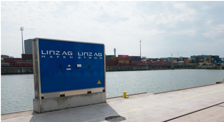
Abb. links und unten Symbolbilder Energieterminal mit Landstromanschlüssen Aufgenommen im LINZ AG HAFEN.
