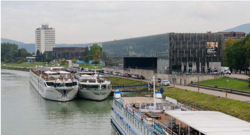
Abb.: Die geplanten Energieterminals können auch zwei hintereinanderliegende Kreuzfahrtschiffe an der Anlegestelle mit Strom versorgen. © Shutterstock
