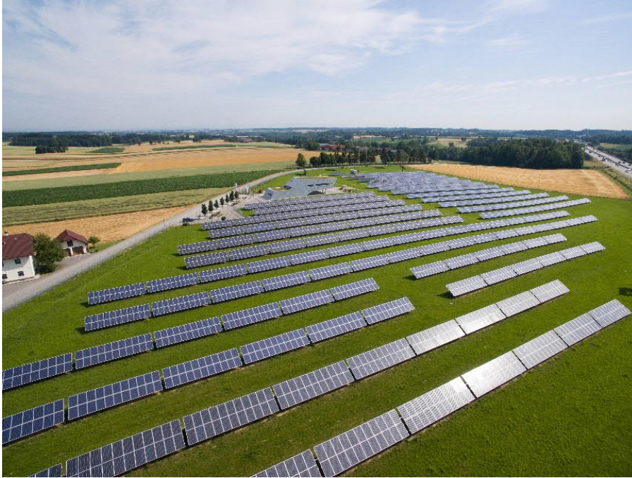
Photovoltaikanlage SolarCampus Eberstälzell (Quelle: Energie AG)
